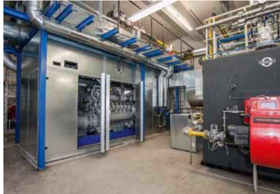
Ein Blick auf den leistungsstarken, mit Erdgas betriebenen Motor.
