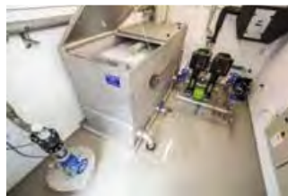
Die neu errichtete Entsäuerungsanlage zur Trinkwasseraufbereitung.
